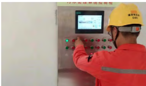
污水处理系统运维管理
