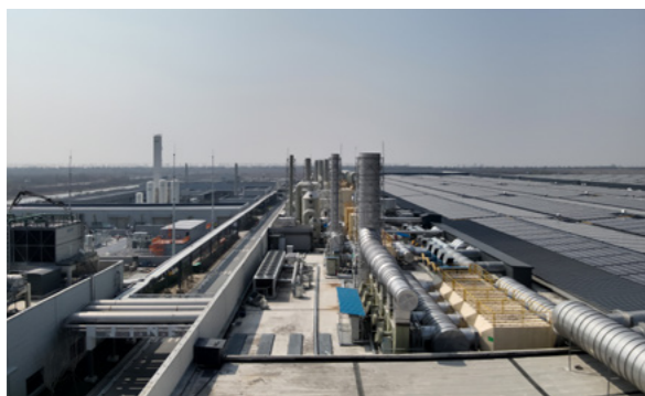
废气治理设施
