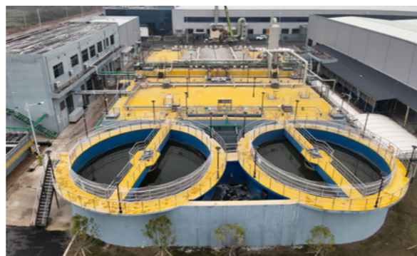
废水治理设施
