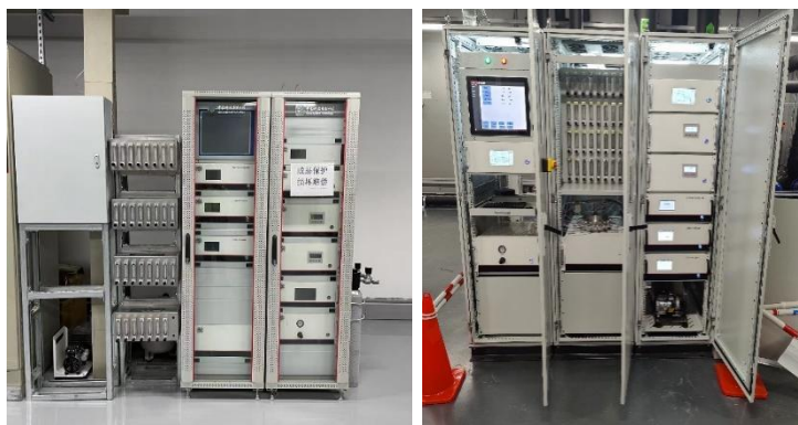
图 15 洁净空间 AMC-1000 微污染气体监测系统客户应用现场
