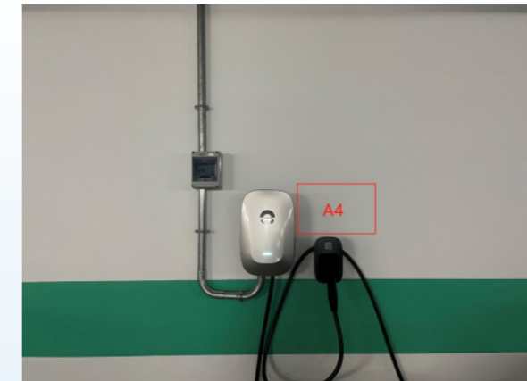
新能源汽车充电桩
