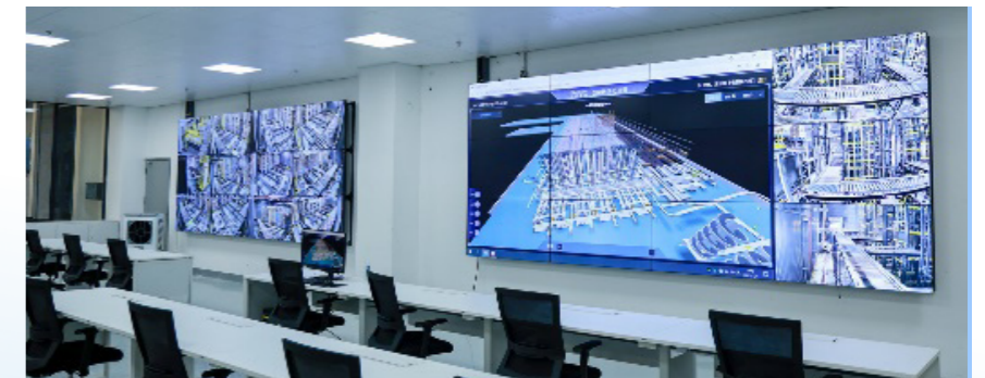
产业园监控中心
