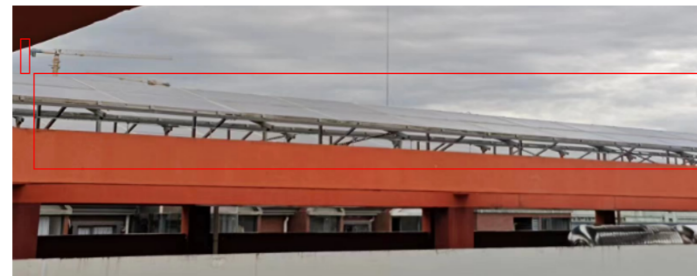
▲ 公司屋顶使用的太阳能板
