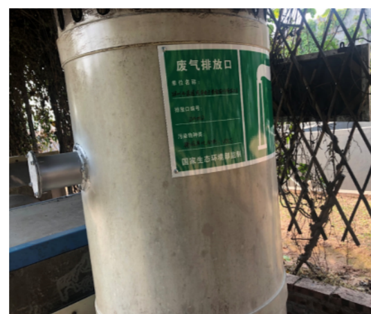
▲ 园区废气处理塔
