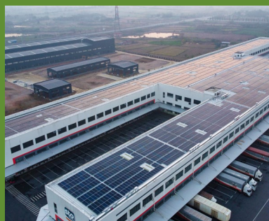
申通快递湖北荆门光伏发电项目
