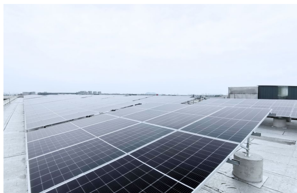
申通快递杭州转运中心分布式光伏项目
