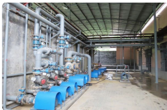
深度废水处理系统吸附剂溶解槽
