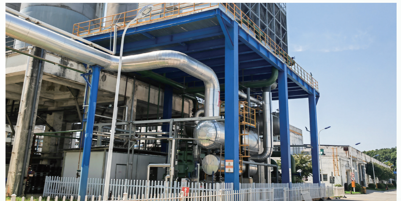
> 酯化蒸汽余热发电项目
