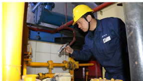
乌海发电厂运行人员开展磨煤机润滑油站隐患排查
