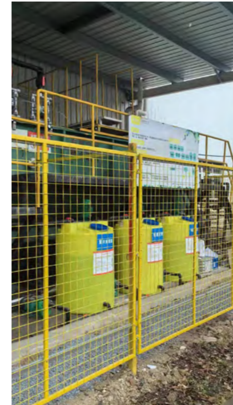
▲ 合肥家电污水站
