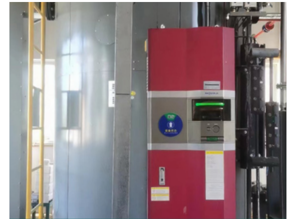
▲ 天然气锅炉及控制柜
