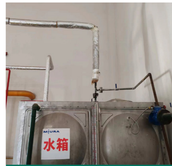
▲ 锅炉冷凝水回收水箱
