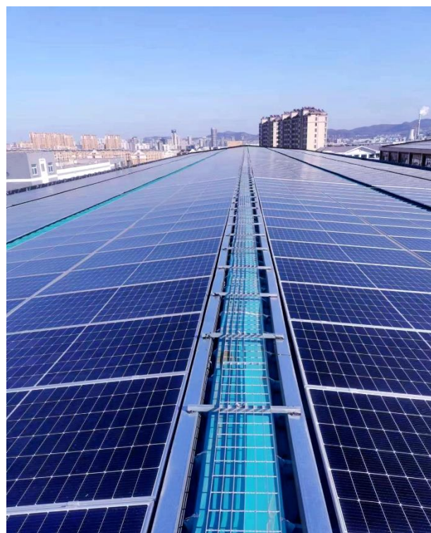
威海生产基地楼顶光伏
