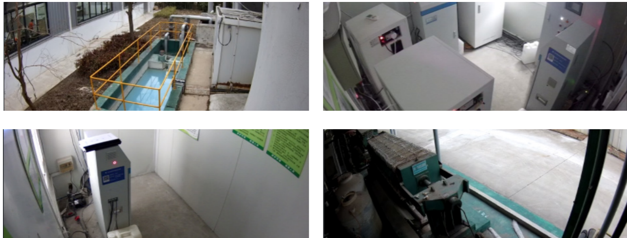
污水站排出口、自动监测区域监控联网至环保局
