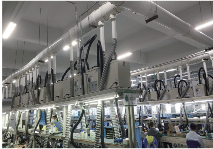
DIP废气管道
