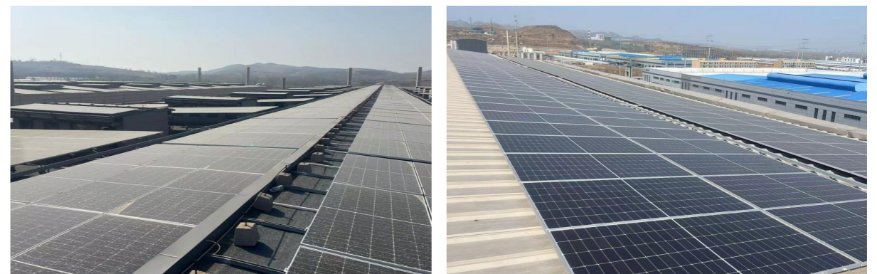
山东健康科技光伏发电项目
