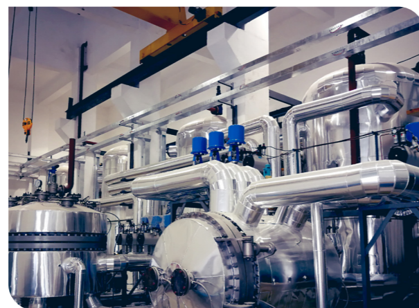
核电站用电缆 LOCA 实验室
