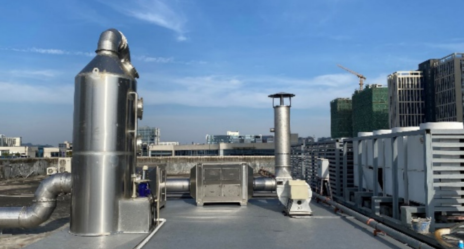
废气处理装置
