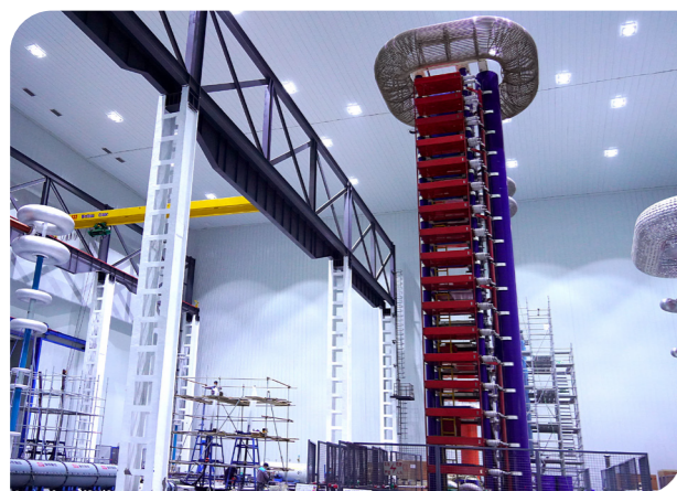
超高压交直流电缆实验室
