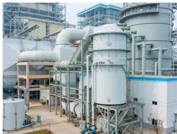
宜城电厂脱硫废水深度处理装置
