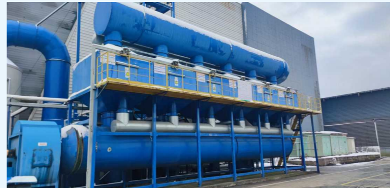
江西格林循环废气处理设施 ▶
