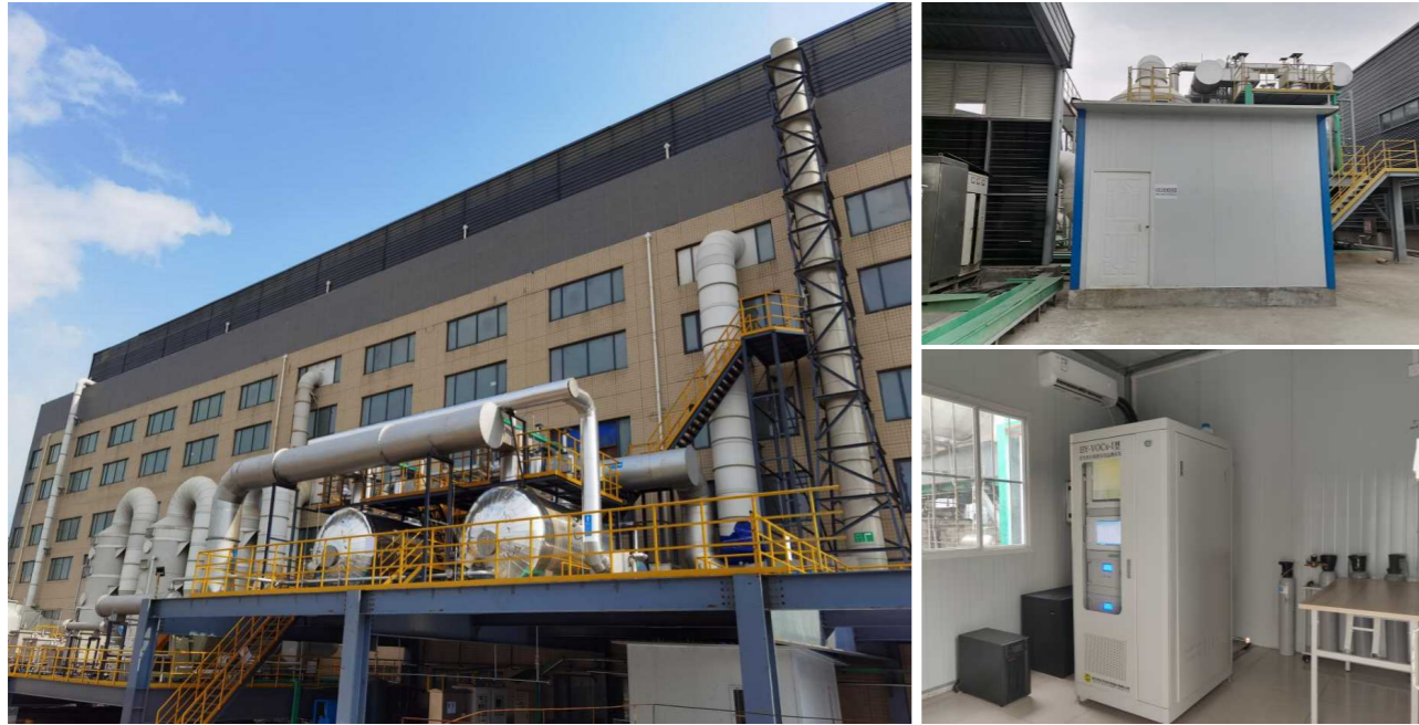
荆门园区VOCs回收循环利用装置
