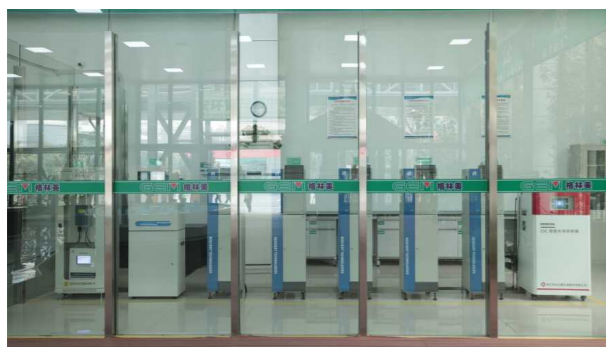
荆门园区废水在线监测站房
