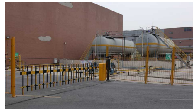
液氮站封闭管理
