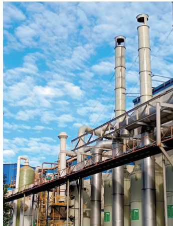
江西三和公司废气处理设施
