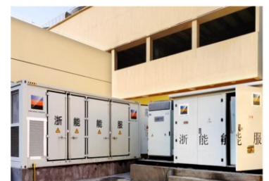
储能电站项目
