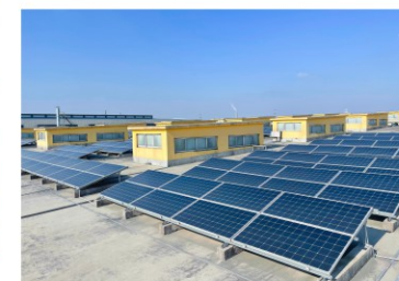
分布式光伏发电项目
