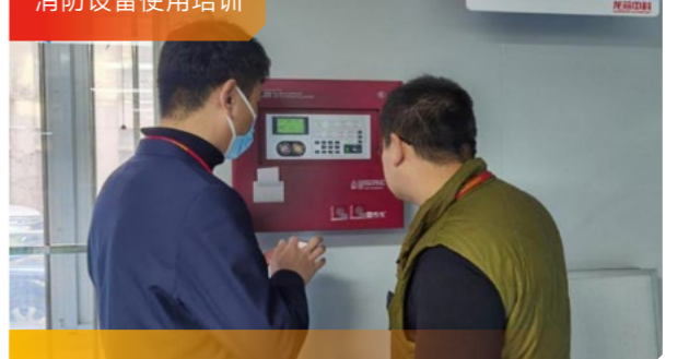
消防设备使用培训
