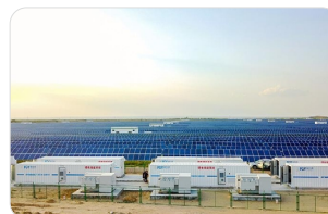
◇ 新能源发电站配储项目产品及EPC
