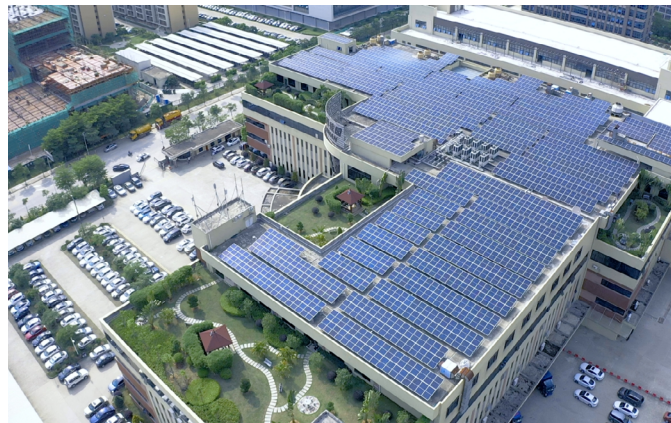
◇ 九联科技分布式光伏发电系统
