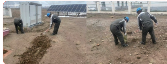
● 协和天颂共和光伏电站防汛防灾工作
