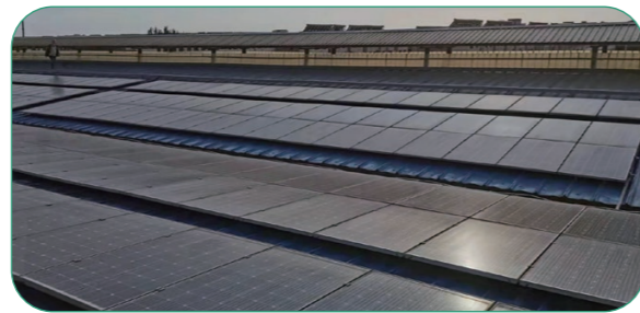
● 太阳能光伏发电项目
