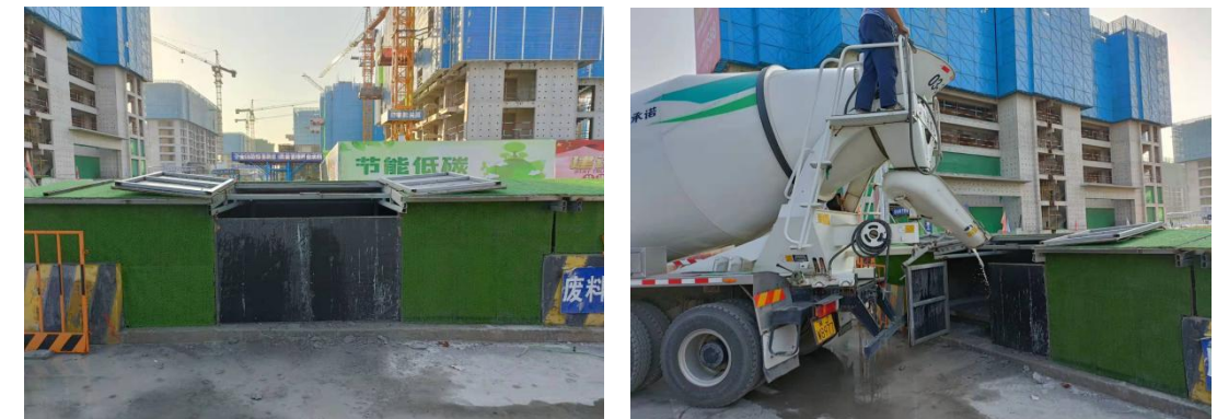
罐车冲洗池以及废水收集池
