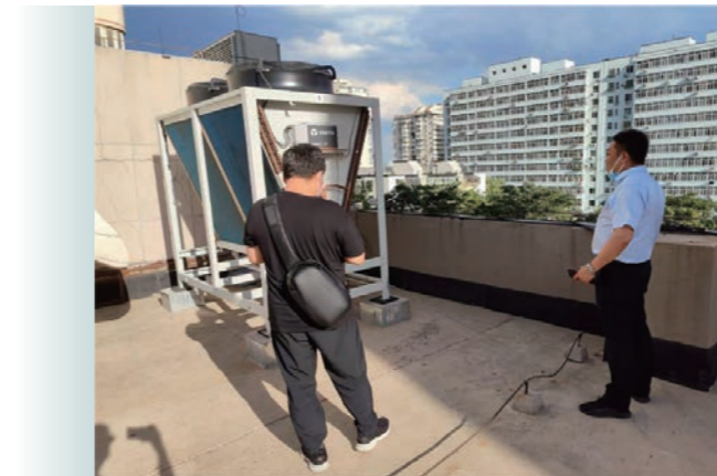
• 精密空调室外机隔音降噪改造前
