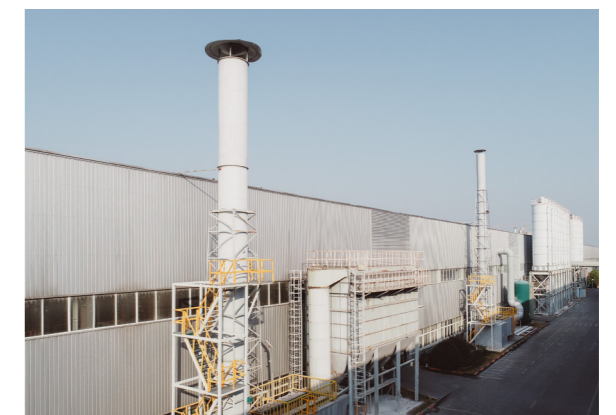
亚士创能科技（滁州）有限公司粉尘处理
