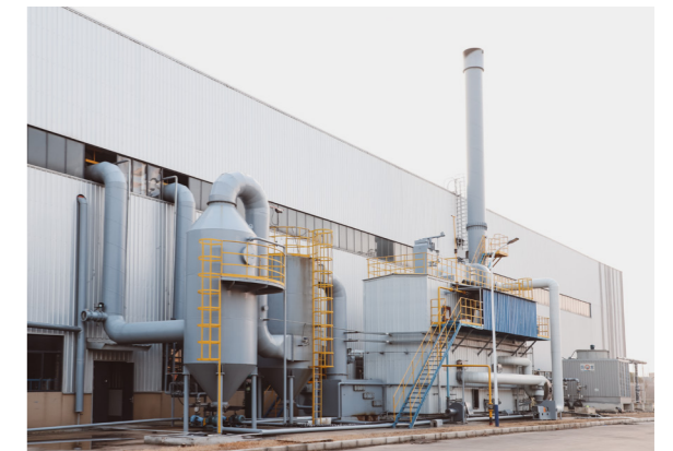
亚士防水科技（滁州）有限公司 RTO 进行废气处理
