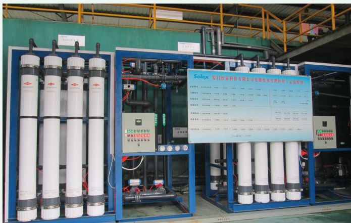
▲ 废水回收处理站
