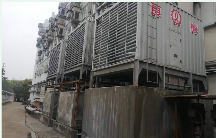
▲ 注塑冷却循环用水
