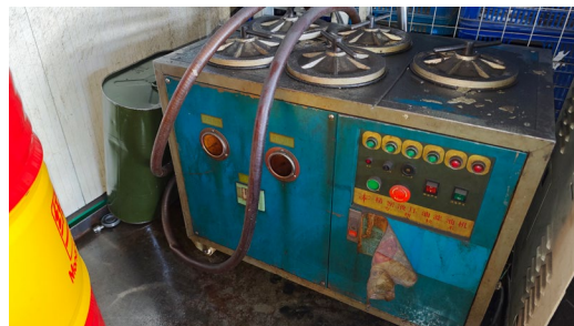
▲ 废油回收装置
