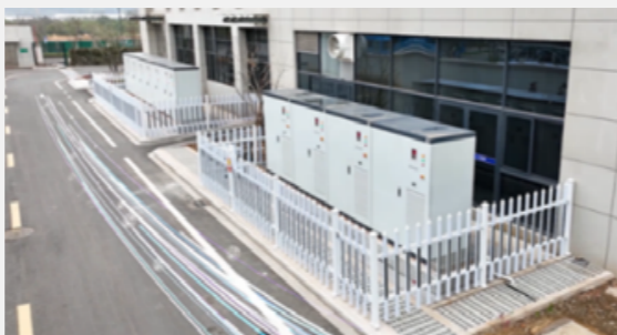
▲ 三花商用制冷储能电站
