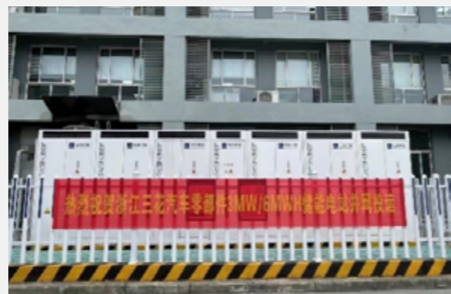
▲ 三花汽零储能电站
