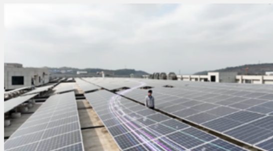
▲ 三花商用制冷太阳能光伏系统
