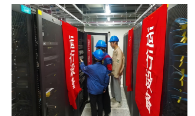
◎ 武汉南瑞专业保障助力大运会电力稳定可靠供应
