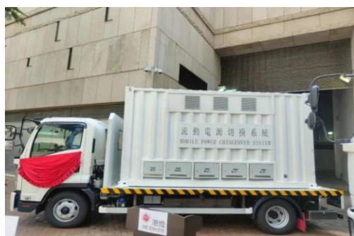
图：香港电灯有限公司移动储能装置在香港数码港变电站交接
