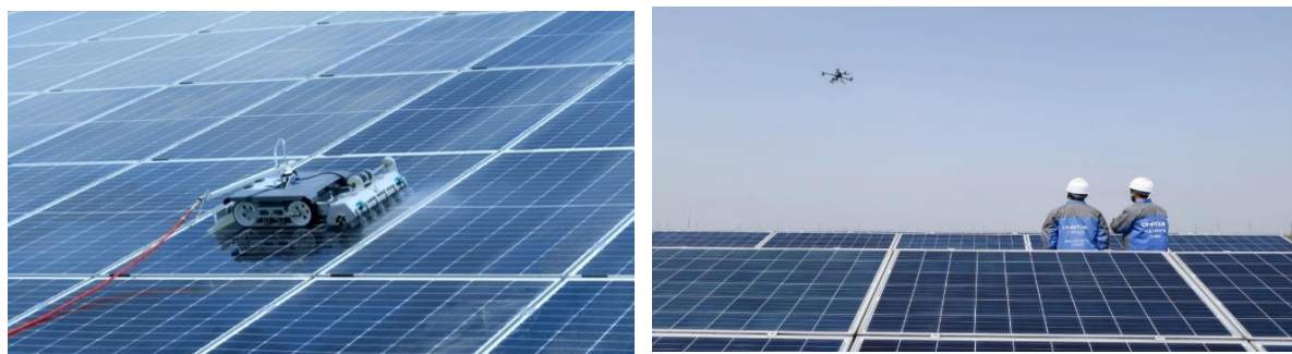
图 10：正泰安能智能化运维
