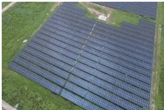
固定式支架光伏区域
