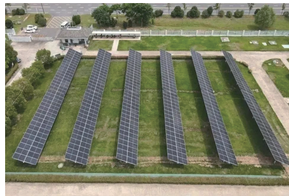
跟踪支架光伏区域
