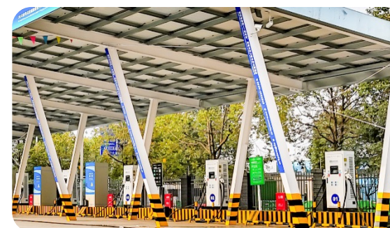
直流母线光储充电站项目
