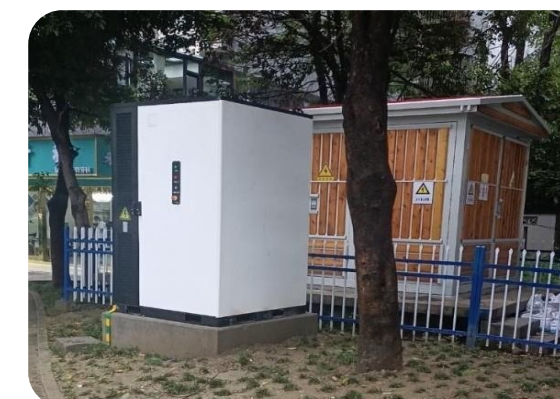
琉璃街分布式储能项目
