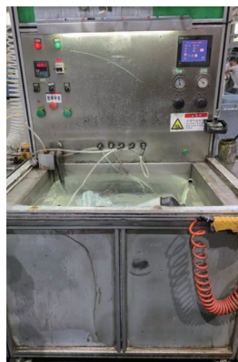
改造前的水试台位
