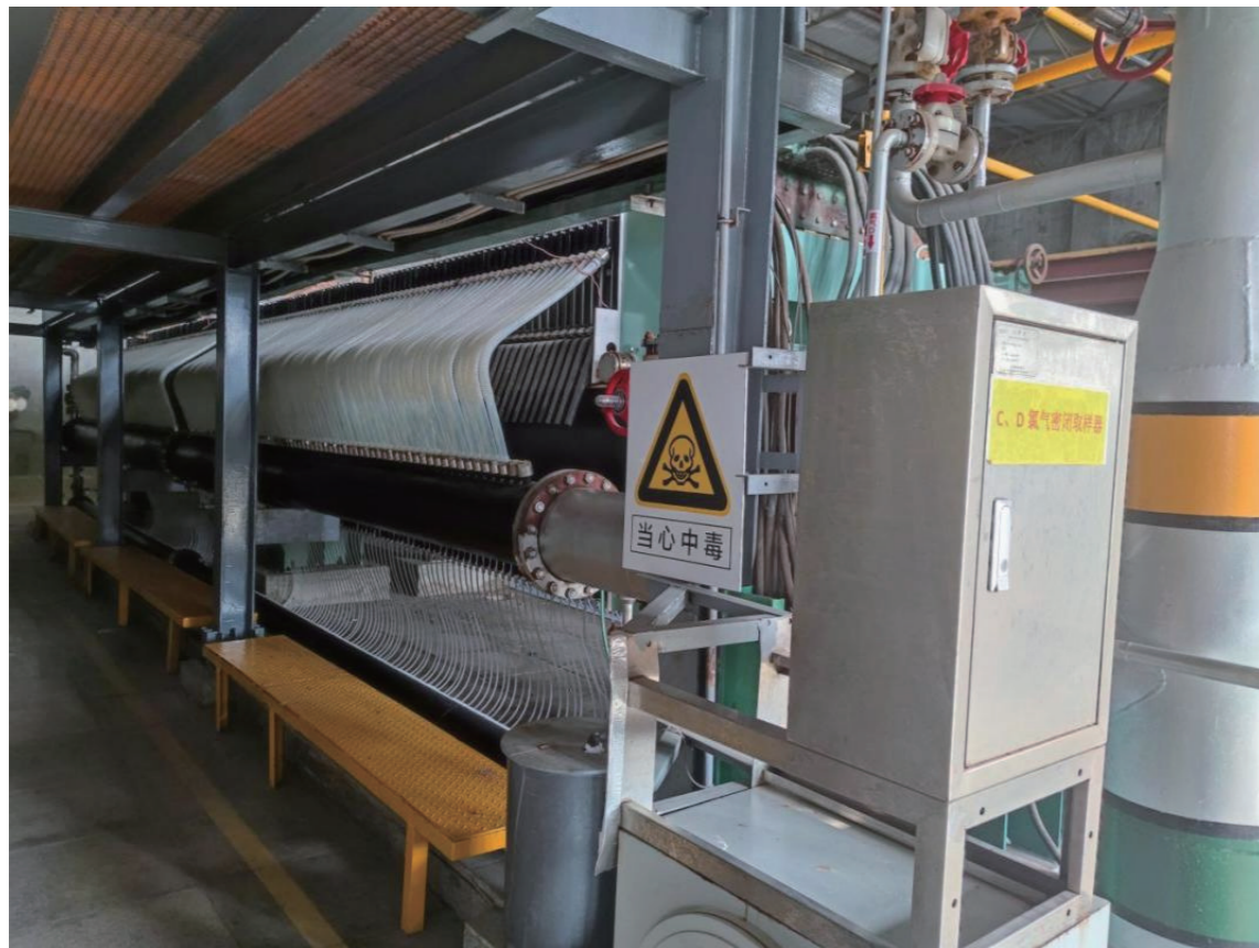
▲ 新型电解槽设备
