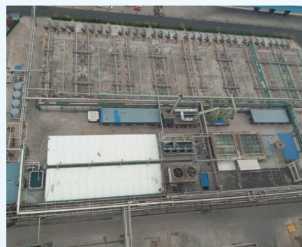
碳一生化处理装置
