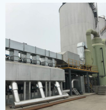
乙二醇生化配套的废气处理设施
