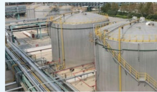
罐区废气回收装置
