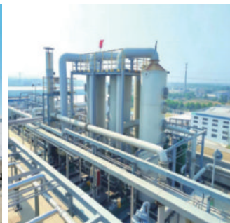
利民化学三级喷淋吸收装置
