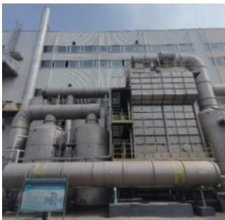
新威远发酵车间废气治理设施
