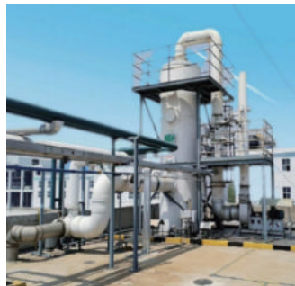
利民化学尾气喷淋装置
