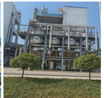
利民化学氯乙烷树脂吸附装置
