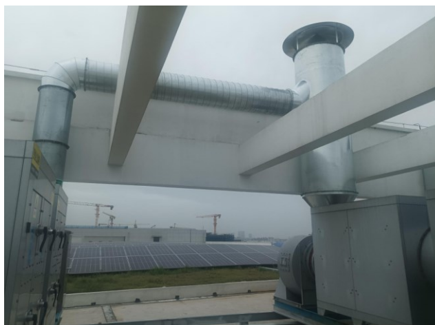
图注：废气处理设备
