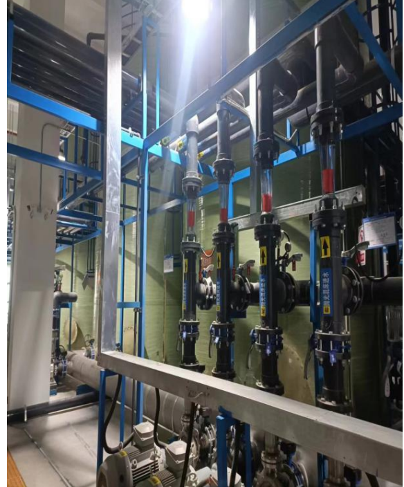
精处理系统终端供水单元
