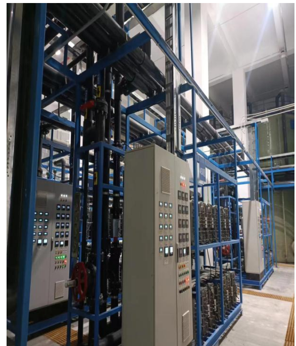
精处理系统连续电除盐单元
