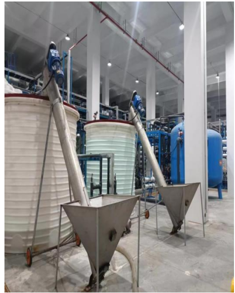
预处理系统软化器加盐再生单元
